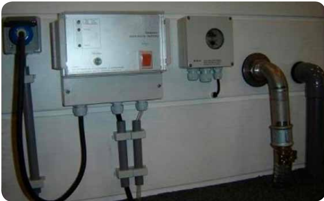
Pompbesturing (links), naast thermostaatkast, wanddoorvoer en ontluchting.
