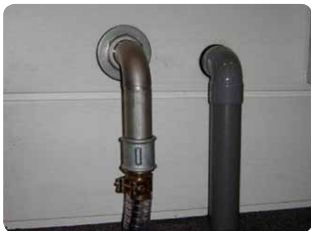
Wanddoorvoer (links) en ontluuchtingsleiding.
